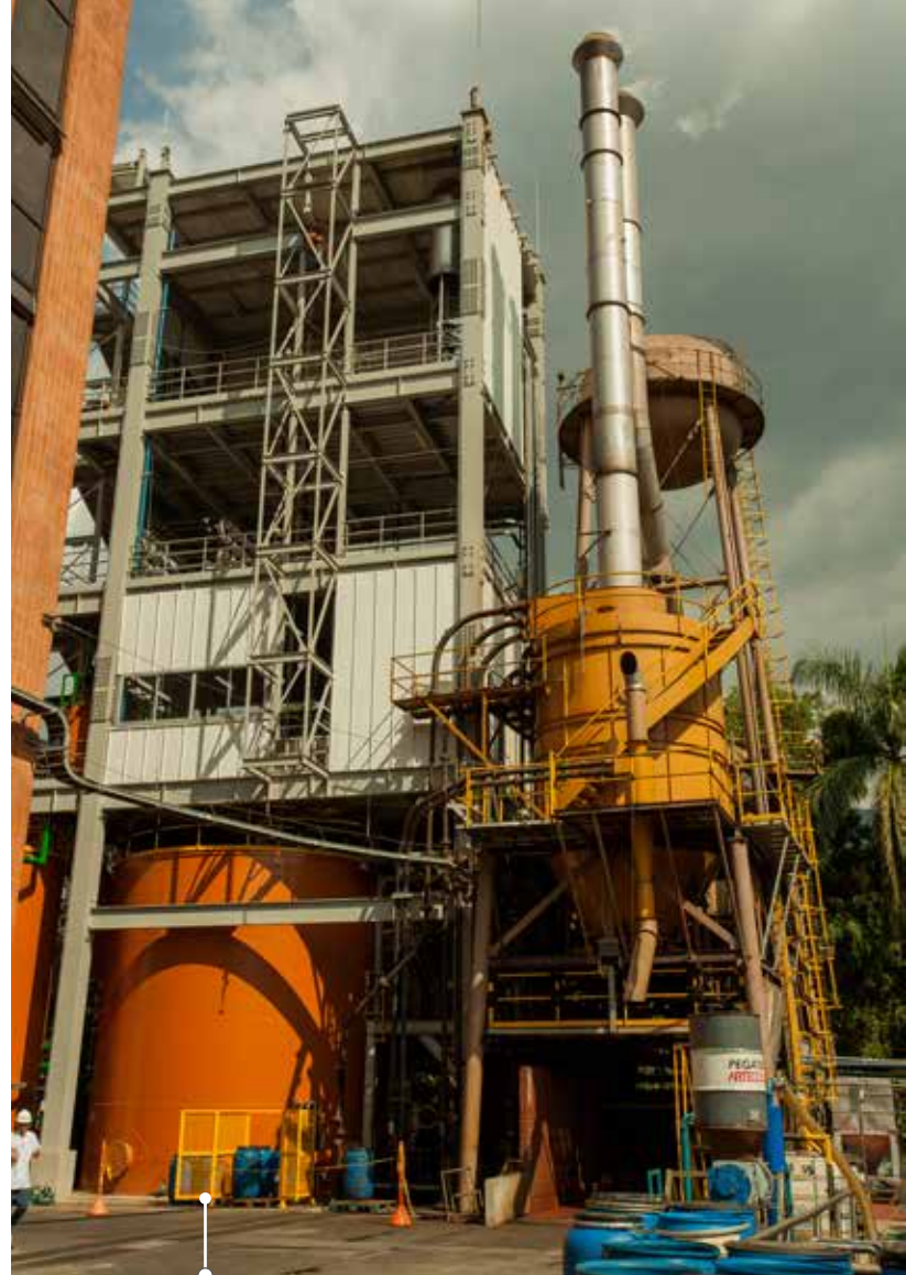
Planta de tratamiento de aguas residuales en la sede del Negocio Cafés en Medellín, Colombia.
